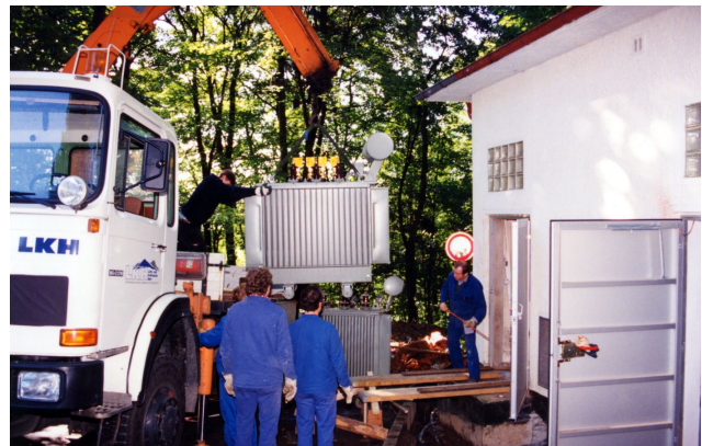
Abbildung 9: LKH-Kran hebt den neuen Trafo in die Station Teichtal (1994) Foto: H. Weidemeyer
