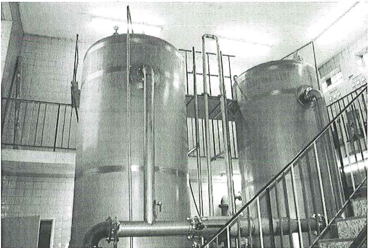
Abbildung 8: Die neuen Filterbehälter im Frühsommer 2004 direkt nach der Installation. Die Arbeiten waren noch nicht vollständig abgeschlossen. Oben rechts die neuen Schaltschränke für das Wasserwerk und den Notstrom-Diesel.
